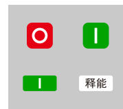
断路器合闸且无储能状态
